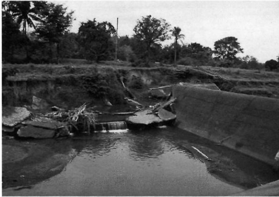
写真7 台風洪水で決壊したアンガス川のコンクリートダム
