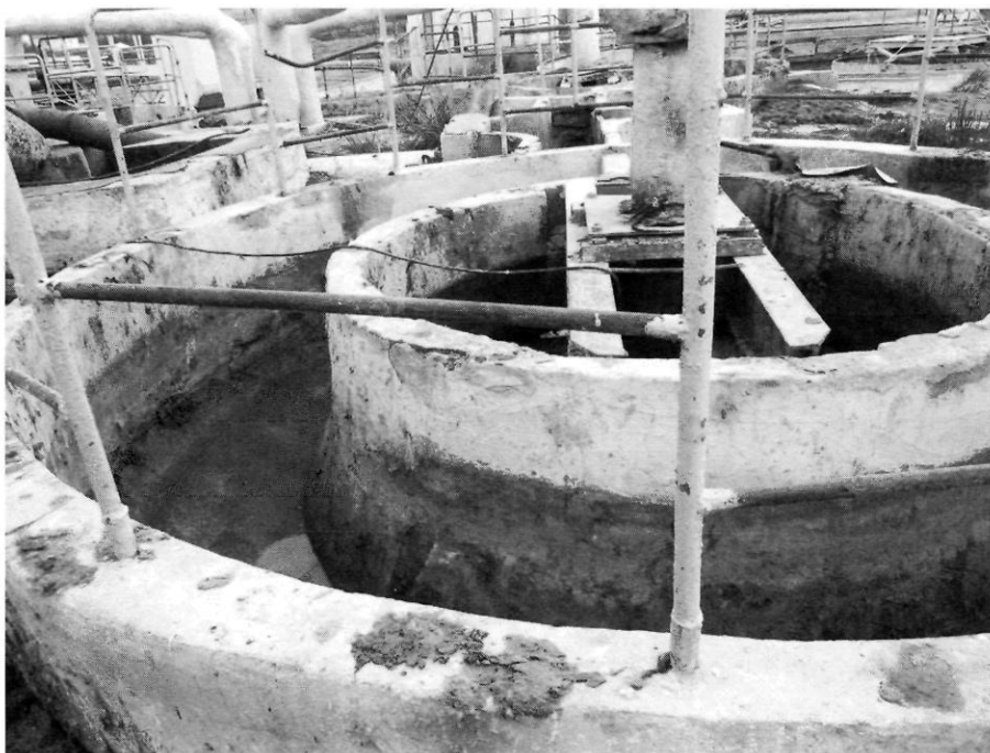
写真1 老朽化著しい廃水処理施設(筆者撮影)
